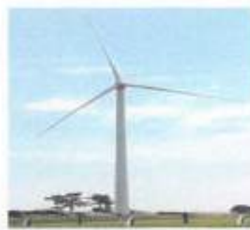
浄化センターの風力発電機
